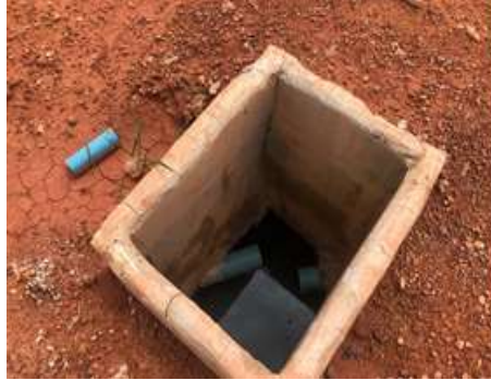
รูปที่ 9 บ่อตกตะกอน
