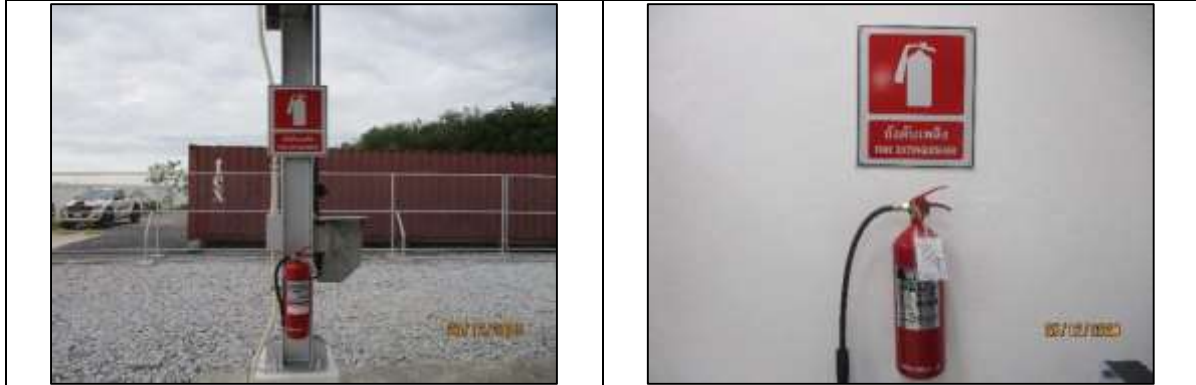
รูปที่ 2-8 ถังดับเพลิงชนิดเคมีแห้ง ในบริเวณสถานีลดความดันก๊าซ และห้องควบคุมของสถานี
