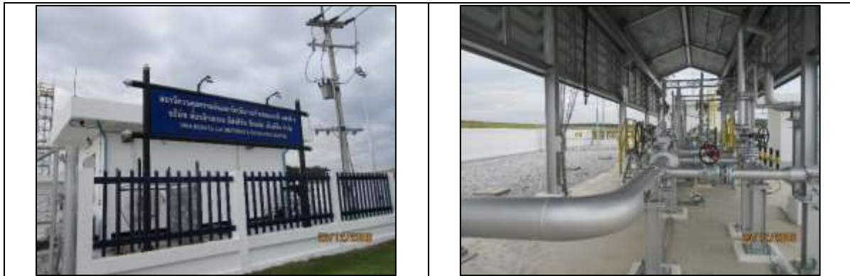
รูปที่ 2-6 สถานีลดความดัน Secondary Gate Station
