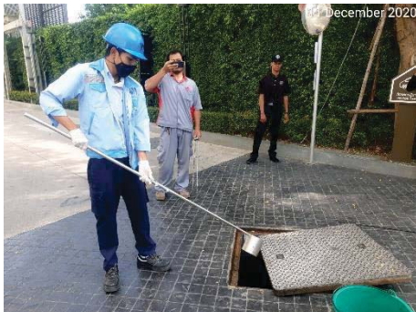
น้ำก่อนเข้าระบบบำบัดน้ำเสีย ชุดที่ 3
