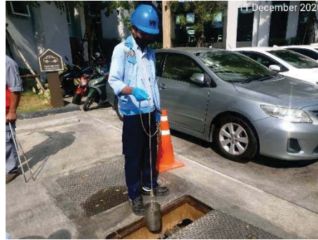
น้ำหลังผ่านระบบบำบัดน้ำเสีย ชุดที่ 2
