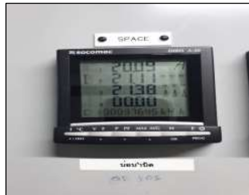
ภาพที่ 47 มิเตอร์ไฟฟ้าระบบบับน้ำเสีย
