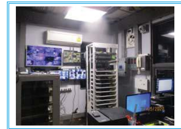
รูปที่ 2.4-22 ระบบสัญญาณโทรทัศน์วงจรปิด (CCTV) ภายในอาคาร
