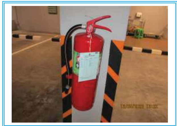
รูปที่ 2.4-15 ถังดับเพลิง
