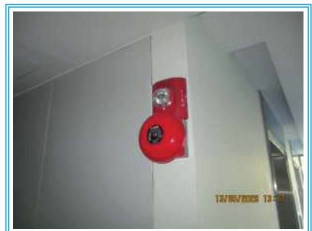
รูปที่ 2.4-13 อุปกรณ์แจ้งเหตุเพลิงไหม้
