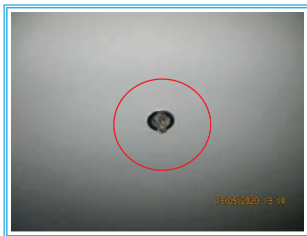
รูปที่ 2.4-6 ระบบสปริงเกอร์
