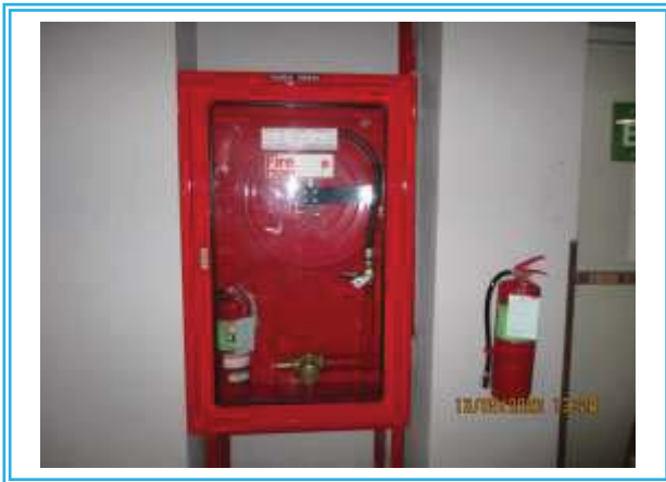
รูปที่ 2.4-14 ตู้หัวฉีดดับเพลิง
