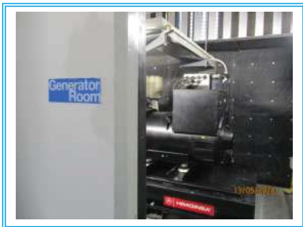
รูปที่ 2.4-10 เครื่องกำเนิดไฟฟ้าสำรอง
