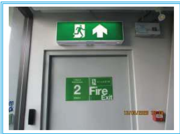
รูปที่ 2.4-16 บันไดหนีไฟ
