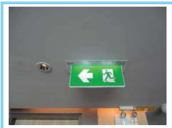
รูปที่ 2.4-18 ป้ายบอกทางหนีไฟ
