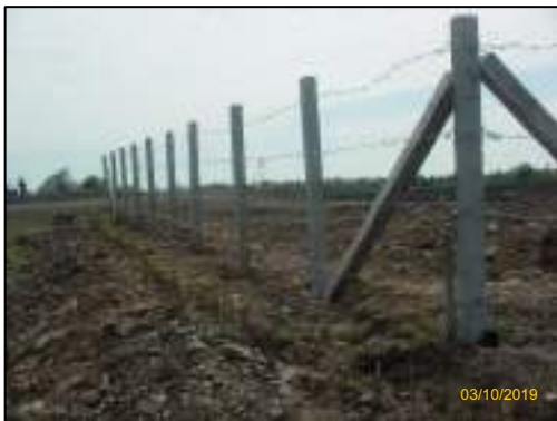
รูปที่ 2-5 การจัดทำรั้วกันขอบถนนสาธารณะ ตลอดแนวที่ทำเหมือง
