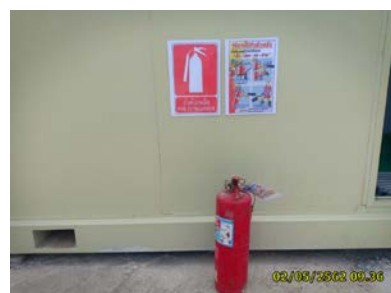
ภาพที่ 2-24 ดังดับเพลิง
