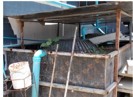
ภาพที่ 2.2-5 ถังบำบัดน้ำเสียบริเวณพื้นที่โครงการ
