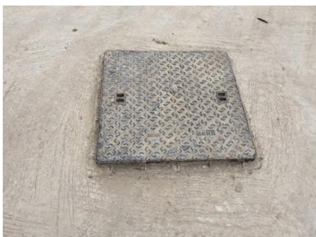
ภาพที่ 2.2-6 ระบบระบายน้ำสาธารณะบริเวณหน้าโครงการ
