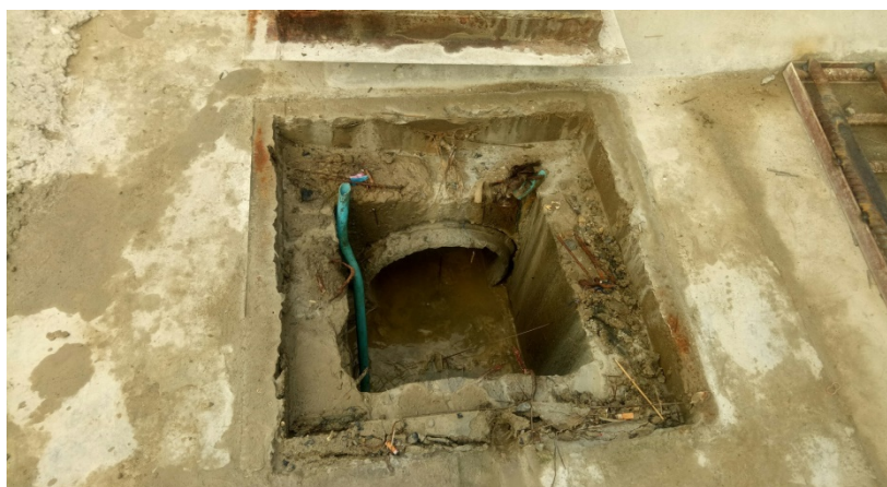
รูปที่ 4-1 บ่อพักน้ำทิ้งแห่ง เมื่อเดือนพฤศจิกายน 2561
